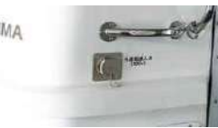
(21)100V電源引込装置
