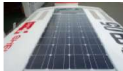
(19-1)太陽光パネル
