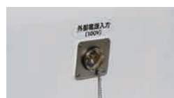
(20)100V電源引込装置 (室外)*2
