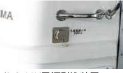
(21)100V電源引込装置
