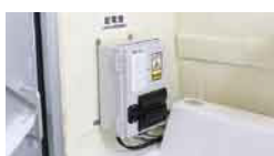
(20)100V電源引込装置(室内)*2
