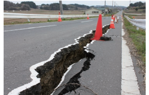
写真：東日本大震災 千葉海浜地区の液状化現象
