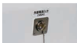
(20)100V電源引込装置 (室外)*2
