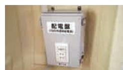
(20)100V電源引込装置 (室内)*2
