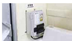
(20)100V電源引込装置 (室内)*2
